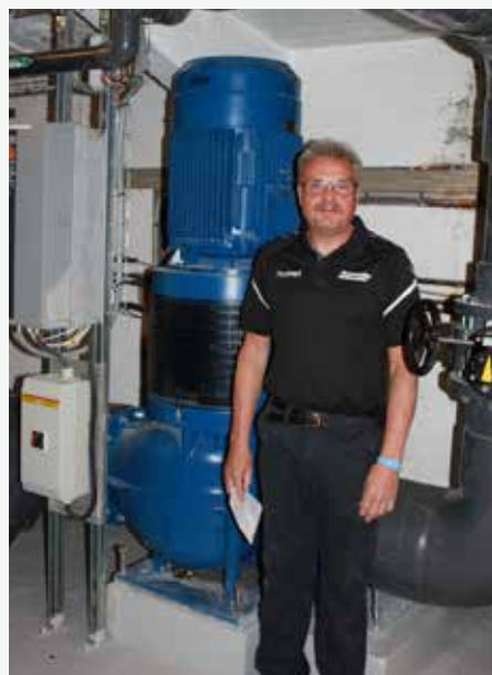
Tommy Pedersen, Teknisk Leder v/Nørresundby Idrætscenter foran DESMI DSL 250-310/D-G pumpe, der pumper 620 m 3 vand i timen.
